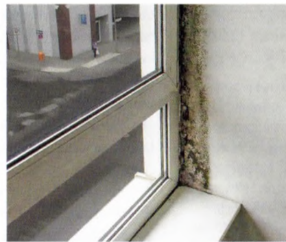
2 Wo die 13°C-Isotherme verläuft, sieht man hier ganz deutlich. Frei nach Bauschäden-Papst Raimund Probst: „Der Schimmelstreifen zeigt an, wo das Fenster gerne eingebaut worden wäre!“
